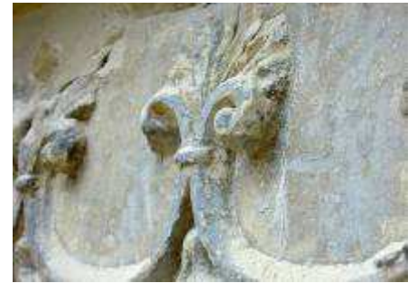
détail de la frise de fleur de lys avant restauration
